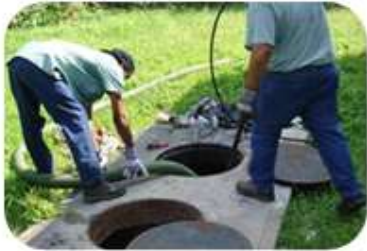
Interceptor de Grasa por Gravedad (GGI) - exterior, concreto
